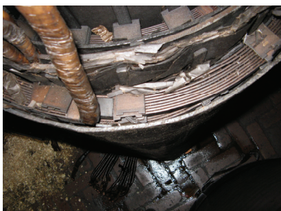
Rys. 7. Transformator TDR-63000/110x. Widok osadów na elementach stałych izolacji
