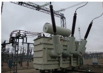
Rys. 2. Widok ogólny transformatora typu OBU 125/510 zainstalowanego na stacji elektroenergetycznej Fig. 2. Overall view of the OBU 125/510 transformer installed in the power station
