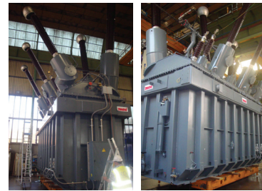
Rys. 11. Widok ogólny transformatora typu ATOE 400A/230T zainstalowanego na stacji prób
