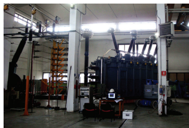
Rys. 7. Widok ogólny transformatora typu ATOE A324 zainstalowanego na stacji prób
