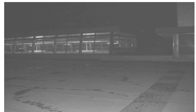
Rys. 2. Termogram i zdjęcie fragmentu badanej powierzchni dachu Fig. 2. Thermal image and photo of the investigated area of the roof
