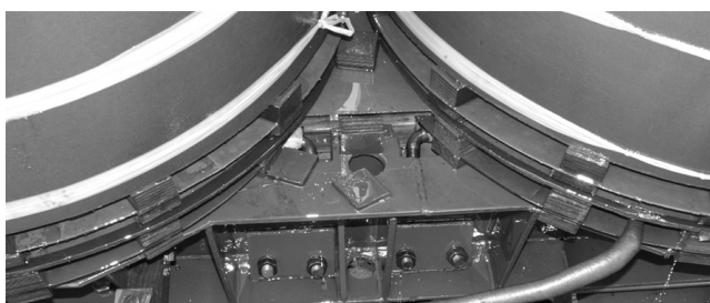
Rys. 1. Widok części aktywnej z wypadniętymi wstawkami dystansowymi Fig. 1. View of the active part with distance inserts fallen out
