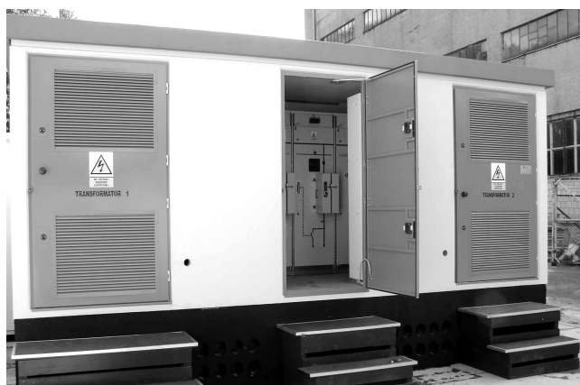
Rys. 1. Widok stacji STLmb-6, 24(17,5)/0,4kV
