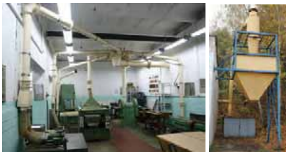
Fig. 2. View of the pneumatic extraction test system Rys. 2. Widok badanej pneumatycznej instalacji odciągowej
