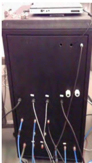
Rys. 5. Szafa pomiarowa umożliwiająca pomiary i ich digitalizację, widok doprowadzeń przewodami zasilania elektrycznego, pneumatycznego, hydraulicznego
