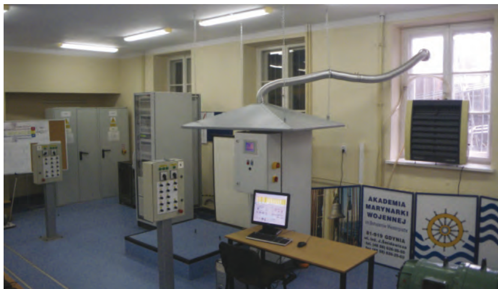
Rys. 1. Demonstrator technologii systemu zasilania elektrycznego oparty na ogniwie paliwowym PEM o mocy 6 kW w Laboratorium napędów elektrycznych Instytutu Elektrotechniki i Automatyki Okrętowej AMW
