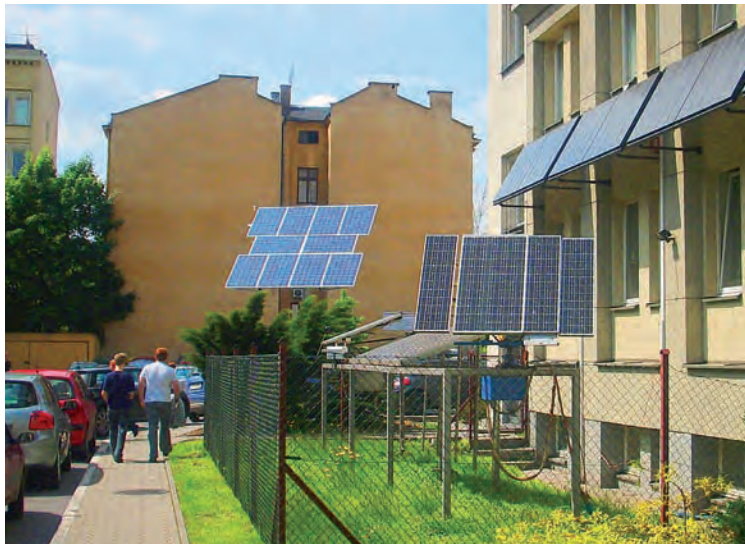
Rys. 2. Niektóre z badanych systemów fotowoltaicznych Fig. 2. Some of tested PV systems
