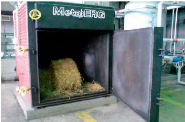
Rys. 2. Widok ogólny kotła na biomasę wraz z instalacją Fig. 2. A general view for biomass boiler with installation
