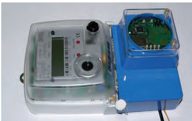
Rys. 5b. Koncentrator danych odczytowych zamontowany w liczniku
