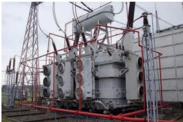
Rys. 1. Ogólny widok badanego autotransformatora typ TLSRB 250000/400 PN
