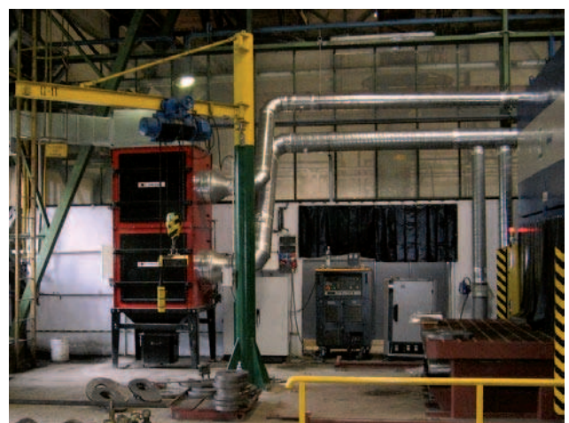
Rys. 6. Zrobotyzowane stanowisko ukosowania blach metodą cięcia plazmowego z wykorzystaniem robota KR 60 firmy KUKA – instalacja odciągowa pyłów i dymów
