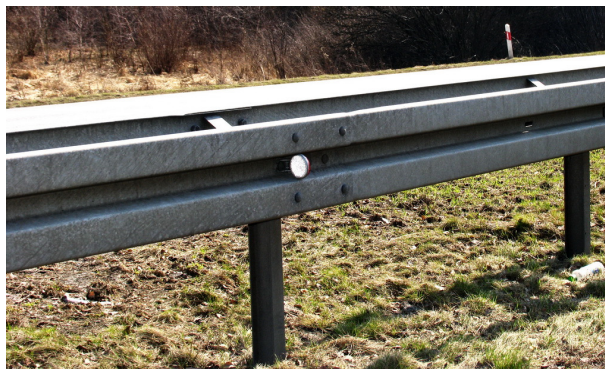
Rys. 6. Stalowa bariera ochronna – element czynnego bezpieczeństwa ruchu Fig. 6. Steel crash barrier – the element of active traffic safety
