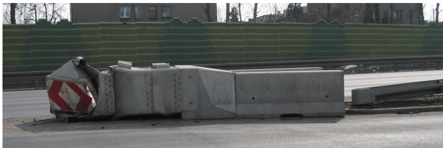
Rys. 7. Bariera energochłonna – element biernego bezpieczeństwa ruchu Fig. 7. Standard crash barrier – the element of passive traffic safety
