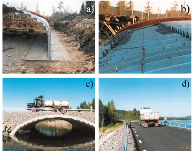
Rys. 2. Analizowany most w widoku: a) na połączenie powłoki z fundamentem, b) na wzmocnienia (żebra) powłoki w przekrojach II–II i III–III; oraz na samochód obciążający używany podczas badań doświadczalnych ustawiany według trzech schematów obciążenia: c) I lub III (niesymetryczny), d) II (symetryczny)
