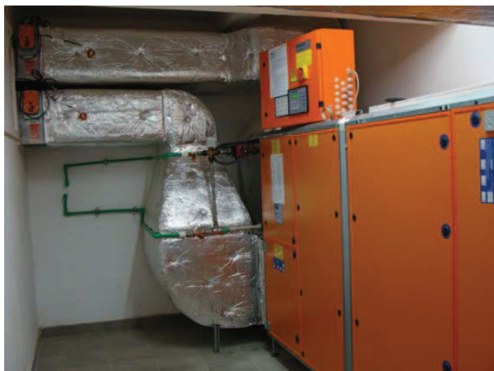
Fot. 4. Centrala wentylacyjna nawiewno-wywiewna dla pomieszczeń sanitarnych (fot. L. Malara) Photo 4. Supply-exhaust ventilation center for the sanitary rooms (photo. L. Malara)
