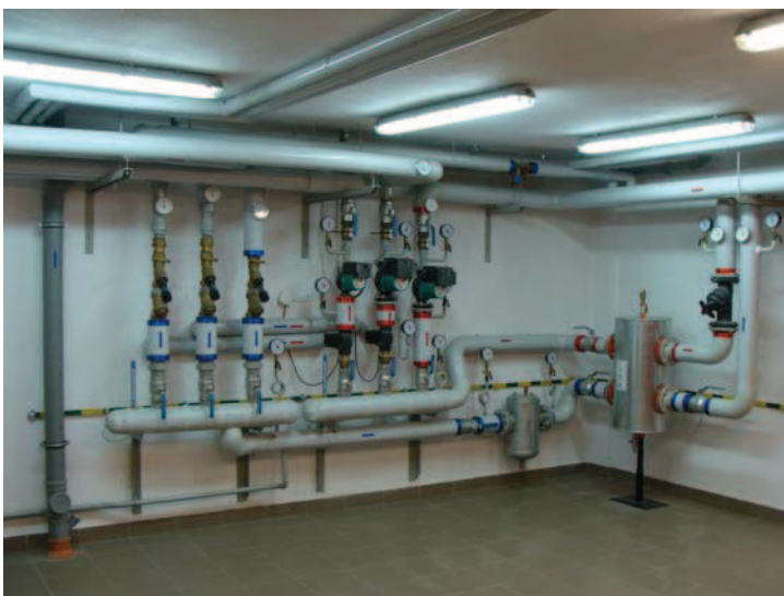
Fot. 1. Zmodernizowany węzeł cieplny w Hali Widowiskowo-Sportowej – część A (fot. L. Malara)
