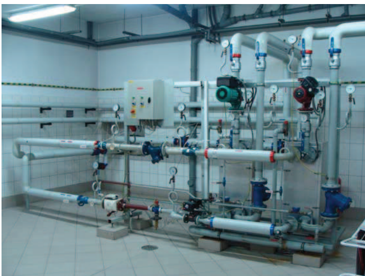
Fot. 2. Zmodernizowany węzeł cieplny w Hali Widowiskowo-Sportowej – część B (fot. L. Malara)
