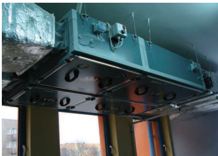
Fot. 5. Centrala wentylacyjna nawiewno-wywiewna dla pomieszczeń sportowych (sala gimnastyczna i fitness) (fot. L. Malara) Photo 5. Supply-exhaust ventilation center for the sports rooms (gymnastic and fitness) (photo. L. Malara)
