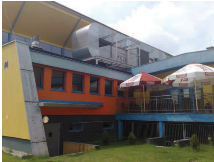
Fot. 6. Centrala wentylacyjna nawiewno-wywiewna z rekuperacją (odzyskiem ciepła) dla głównej Hali Widowiskowo-Sportowej (fot. L. Malara)
