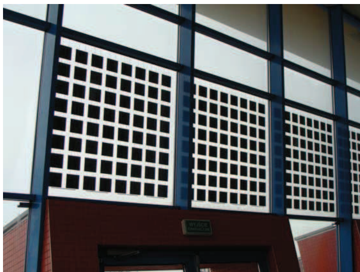
Fot. 7. Zainstalowane moduły ogniw fotowoltaicznych na południowej części przeszklenia Hali Widowiskowo-Sportowej (fot. L. Malara)
