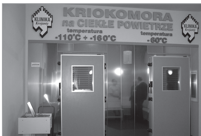
Fot. 18 Prywatna Klinika Rehabilitacji w Krojantach z zainstalowaną komorą kriogeniczną
