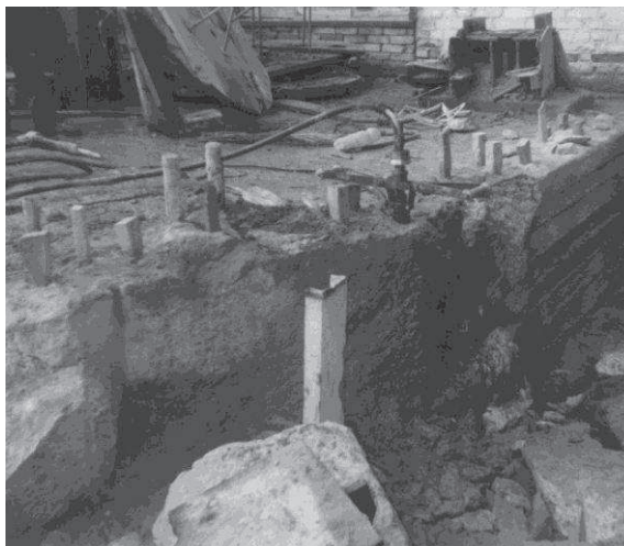
Fot. 2. Zniszczenie fundamentu jednoszynowej drogi w Hucie Jenakijewskiej
