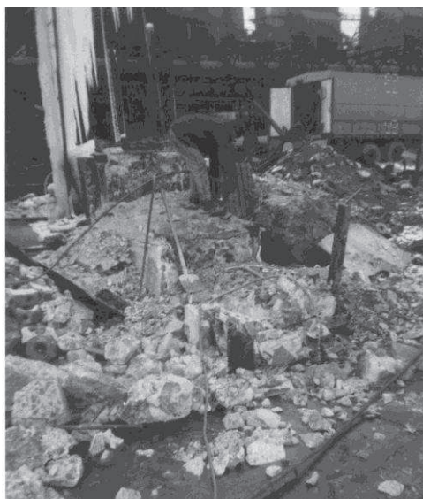
Fot. 3. Zniszczenie podpory betonowej w Hucie Jenakijewskiej (na dalszym planie urządzenie „Impuls-4”)
