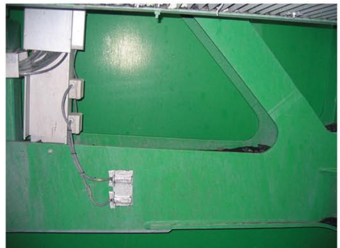
Rys. 4. Czujnik zainstalowany na konstrukcji skrzynkowej pasa dolnego wysięgnika koła czerpakowego
