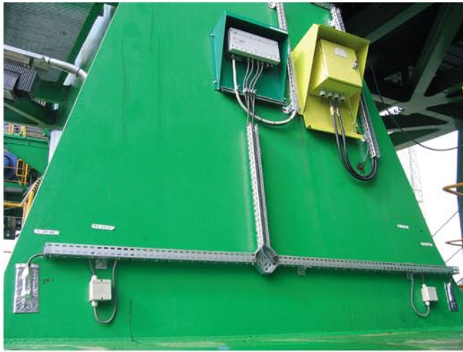
Rys. 5. Czujniki zainstalowane w narożach słupa wieży Fig. 5. Sensors installed in the corners of tower pillar
