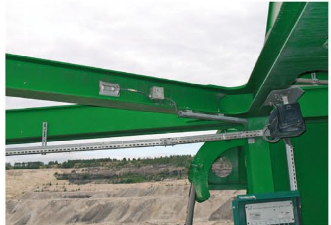
Rys. 3. Czujnik zainstalowany na środku zastrzały stężeń górnych wysięgnika koła czerpakowego
