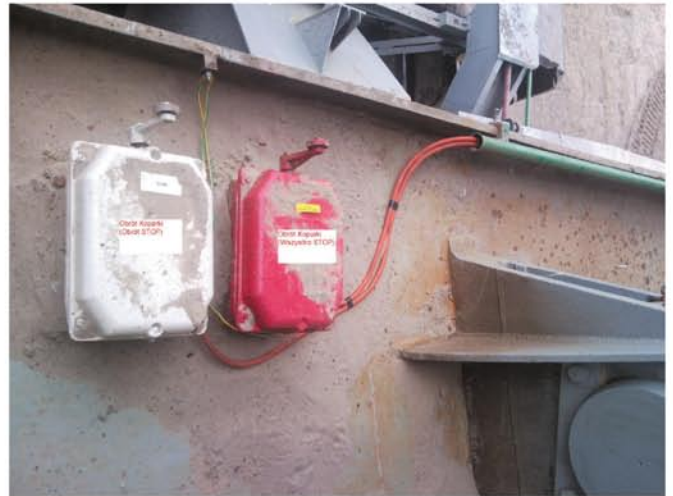
Rys.7. Wyłączniki krańcowe mechanizmu obrotu głównego. Wyłączenie obwodu obrotu (kolor biały). Obwód bezpieczeństwa „WSZYSTKO STOP” (kolor czerwony) Fig. 7. Limit switches of main rotary mechanism. Rotary circuit shutdown (white colour). Safety circuit “ALL STOP” (red colour)
