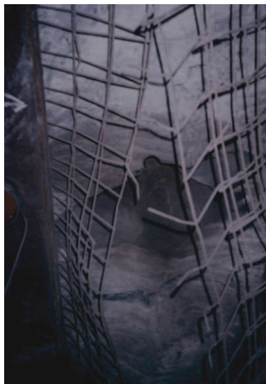
Fot. 2. Strop po odpaleniu 5 kg materiału wybuchowego w pochylni Z-2, pokład 411/1, kopalni „Jankowice”
