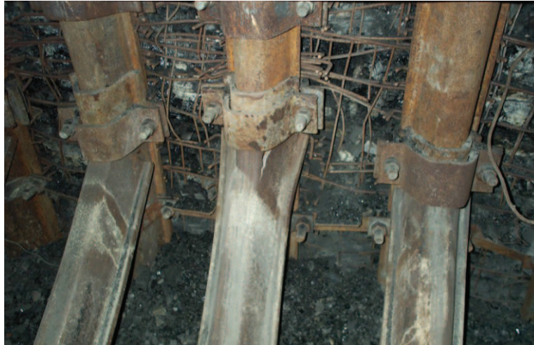
Fot. 1. Uszkodzona spągnica wykonana z kształtownika V36 ze stali 34GJ zabudowana w chodniku polowym
