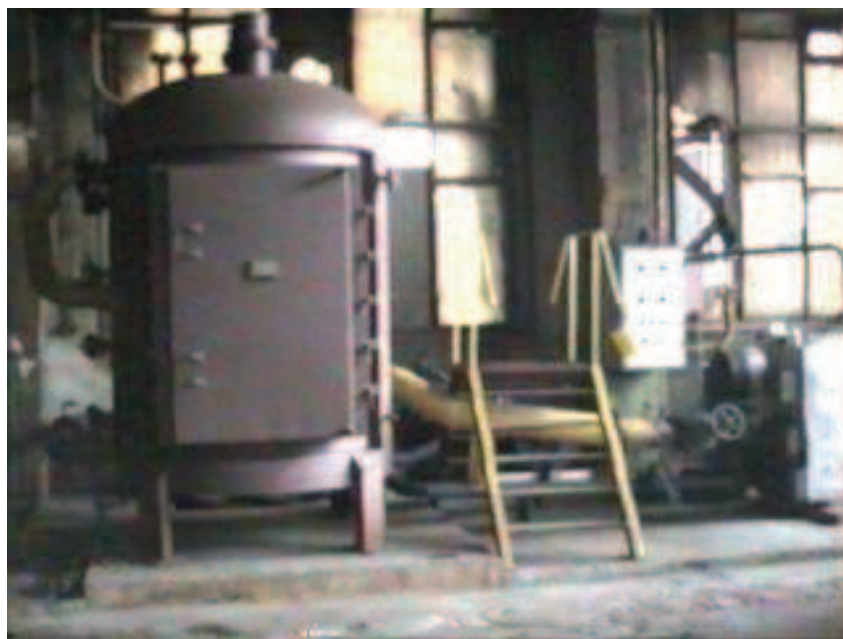
Fot. 1. Reaktor do zgazowania odpadów gumowych
