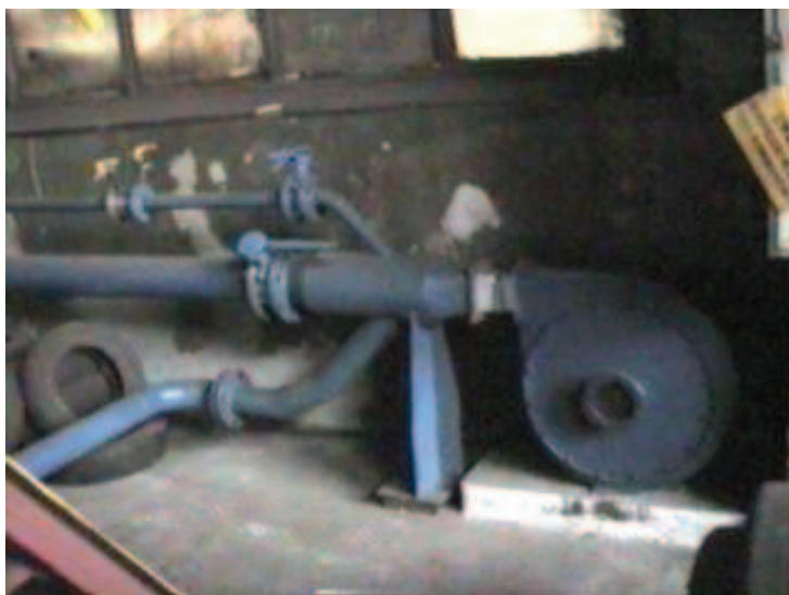
Fot. 3. Wentylator promieniowy doprowadzający powietrze do zgazowania odpadów i spalania gazu procesowego
