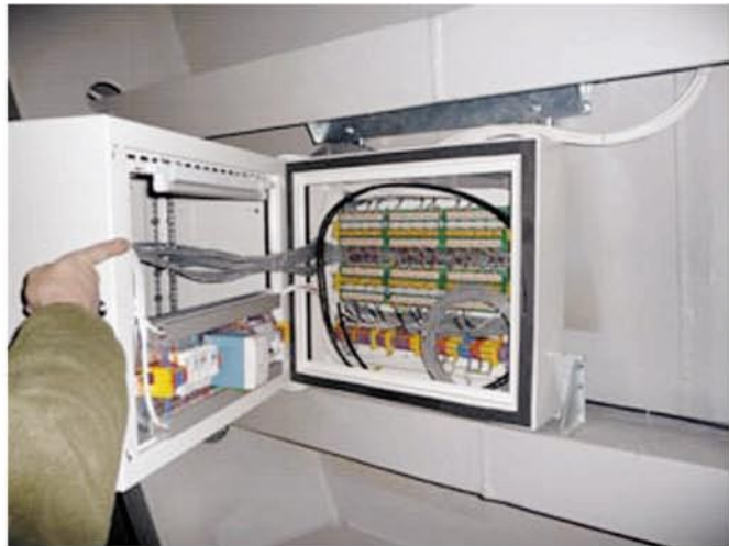
Rys. 7. Widok wnętrza serwera lokalnego zlokalizowanego na moście [3] Fig. 7 Inside view of local server localized on a bridge [3]
