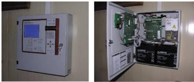
centrala sygnalizacji pożarowej POLON 4100
