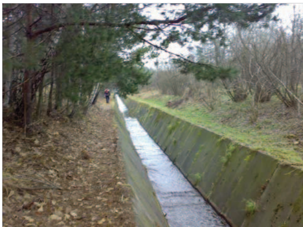
Fot. 2. Odcinek Bobrek 1. Koryto z litych bloków betonowych ułożone pod kątem około 60° stanowi barierę dla ludzi i zwierząt. Równe dno powoduje, że przepływ wody jest gładki, co zmniejsza szansę na jej dotlenienie. W niektórych miejscach konary drzew przewisają nad wodą, co w metodzie RHS jest oceniane jako element pozytywny. Widok w górę rzeki z miejsca, w którym do prawej skarpy brzegowej (na fotografii po lewej stronie) przylega brzeg lasu (fot. Vladimir Mana)
