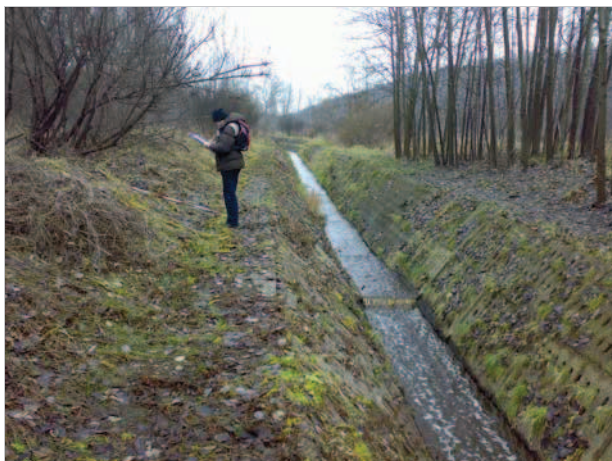
Fot. 1. Odcinek Bobrek 1. Koryto o dnie betonowym i zboczach umocnionych kształtką betonową. W korycie widoczny jeden z dwóch progów dennych występujących na badanym odcinku. Przy obu brzegach – sukcesja roślinna w kierunku lasu liściastego. Podobnie jak na całym badanym odcinku głębokość wody jest znikoma, w dniu obserwacji nieprzekraczająca 10 cm (fot. Vladimir Mana)
