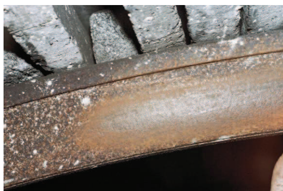
Fot. 3. Powierzchnia kształtownika V przygotowana do pomiaru grubości ścianki (fot. M. Rotkegel)
