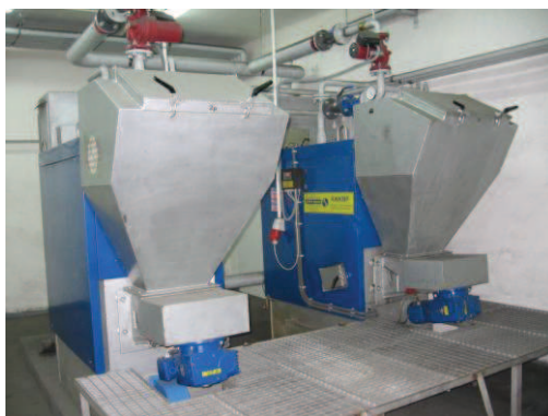
Fot. 5. Kotłownia szkoły C – po wykonaniu wymiany źródła ciepła (fot. L. Malara) Photo. 5. School "C" boiler - after heat source replacement (photo. L. Malara)
