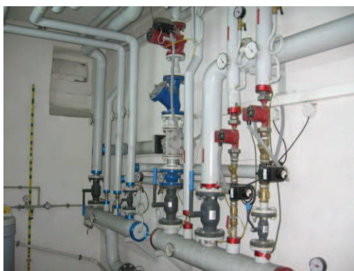
Fot. 6. System instalacji grzewczej w kotłowni szkoły C po modernizacji (fot. L. Malara) Photo. 6. Heating system in school C boiler – room after implementation of modernization improvements (photo. L. Malara)
