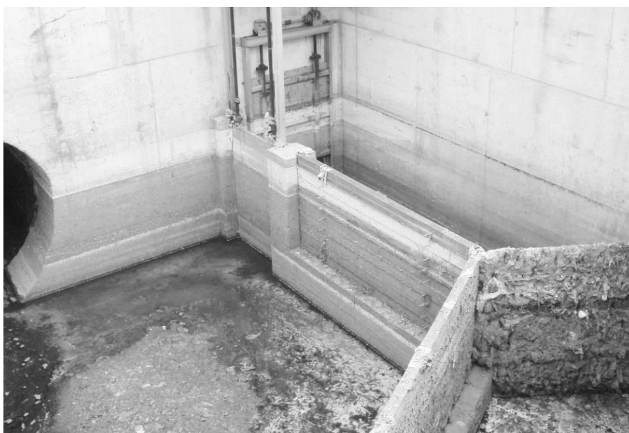
Fot. 4. Komora rozdzielcza zbiornika retencyjnego (Nivus, Gdynia) Phot. 4. Detention tank's separation chamber (Nivus, Gdynia)
