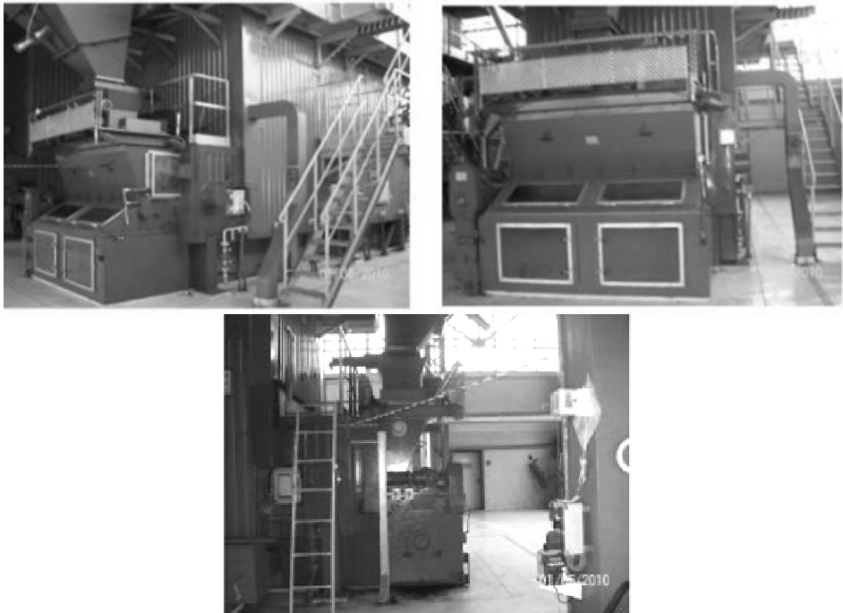
Rys. 1. Kotłownia Ciepłowni w Strzelcach Opolskich Fig. 1. Boiler Room of Heat Plant in Strzelce Opolskie
