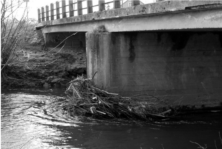
Rys. 1. Skutki nie najlepiej dobranego kształtu filara mostu Fig. 1. Results of inappropriately selected shape of bridge pier
