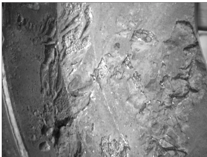
Rys. 8. Zdemontowany kołnierz armatury regulacyjnej z otworu eksploatacyjnego po kilku latach pracy sieci geotermalnej w Bańskiej Niżnej; widoczne ubytki korozyjne (fot. M. Ciosmak 2007)
