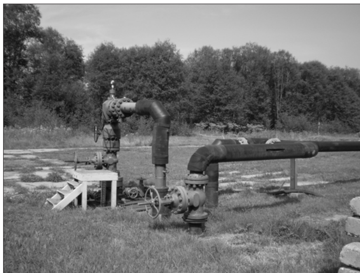
Rys. 7. Gliczarów - otwór zatłaczający wody z rurociągu powrotnego Geotermii Podhalańskiej do warstw triasowych, tymczasowo wyłączony z eksploatacji (fot. M. Ciosmak 2007)
