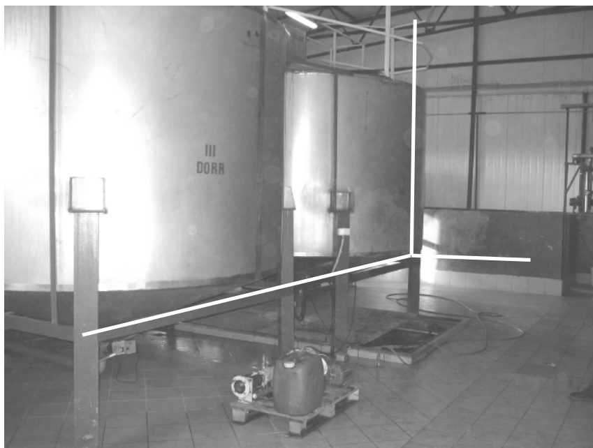
Rys. 7. Osadniki typu Dorra nr III i V w hali podczyszczania ścieków firmy SUPERFISH – strefa przeprowadzonych badań
