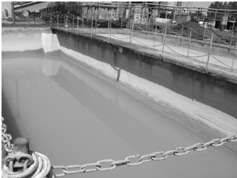
Fot. 1. Osadnik prostokątny obiegu wodno-mułowego zakładu PREFABET w Redzie Photo 1. Rectangular settler in water-sludge circuit in PREFABET Company in Reda
