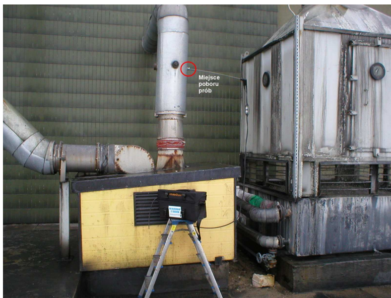
Rys. 8. Punkt pomiarowy stężeń zanieczyszczeń – wentylator wyciągowy Fig. 8. Measurements point of pollutants concentrations – outtake fan
