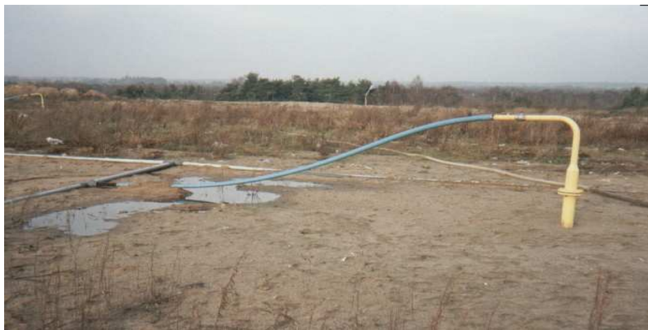
Rys. 11. Odwiert z fragmentem instalacji odgazowującej
