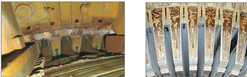
Rys. 3. Uszkodzenia termiczne pierścienia dociskowego oraz położonych pod nim blach rdzenia stojana Fig. 3. Thermal damage of the clamping ring and the stator core laminations located under it
