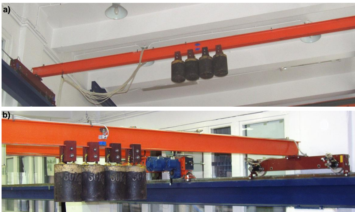
Rys. 4. Widok eksperymentalnego bisymetrycznego ustroju nośnego dźwignicy wraz z ładunkiem: a) widok z dołu, b) widok z poziomu torowiska
