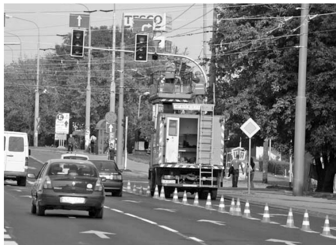
Fot. 1. Budowa sieci trakcyjnej na skrzyżowaniu ul. Roztocze i al. Kraśnickiej, 23.09.2007 r., fot. M. Połom.
