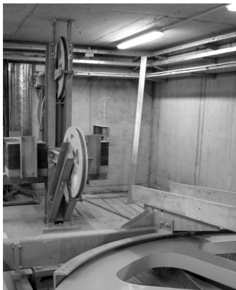
Fot. 6. Układ napinający linii napędowej zlokalizowany w stacji dolnej (fot. Andreas Jenny)
