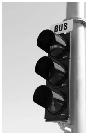
Fot. 2. Specjalna sygnalizacja świetlna dla pojazdów transportu zbiorowego na oddanej do eksploatacji w 2011 r. przebudowanej ul. Chwarznieńskiej w Gdyni Źródło: materiały MZKG.
