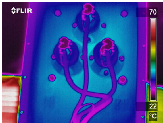
Rys. 6. Ocena temperatur we wnętrzu skrzynki przyłączowej silnika budowy wzmocnionej
