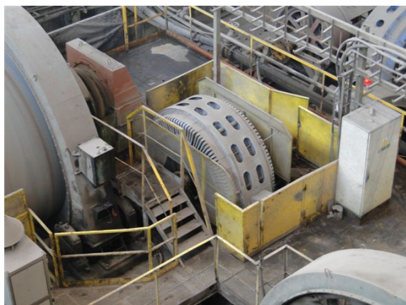
Rys. 2. Silnik w otoczeniu urządzeń technologicznych
