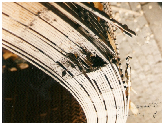
Rys. 5. Miejsce zwarcia uzwojenia fazy „B” GN 220 kV
