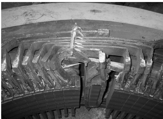
Rys. 3. Uszkodzenie prętów i połączeń uzwojenia kompensacyjnego
