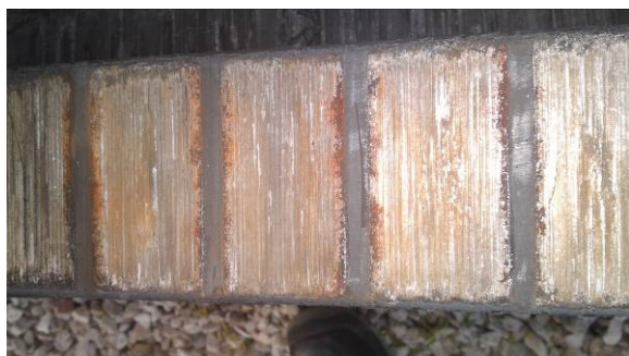
Rys. 11. Uszkodzona warstwa półprzewodząca pręta turbogeneratora 150MW
