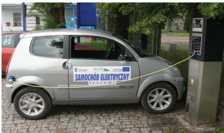
Rys. 2. Publiczny Punkt Ładowania samochodów elektrycznych zainstalowany w Warszawie przy Instytucie Elektrotechniki
