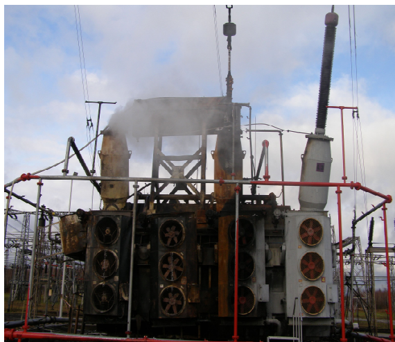
Rys. 4. Uszkodzony w wyniku eksplozji przepustu izolatorowego fazy L1 strony 400 kV i pożaru bliźniaczy transformator 250 MVA
