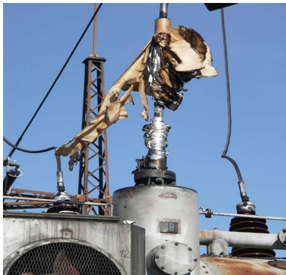
Rys. 2. Uszkodzony przepust izolatorowy 220 kV transformatora 160 MVA
