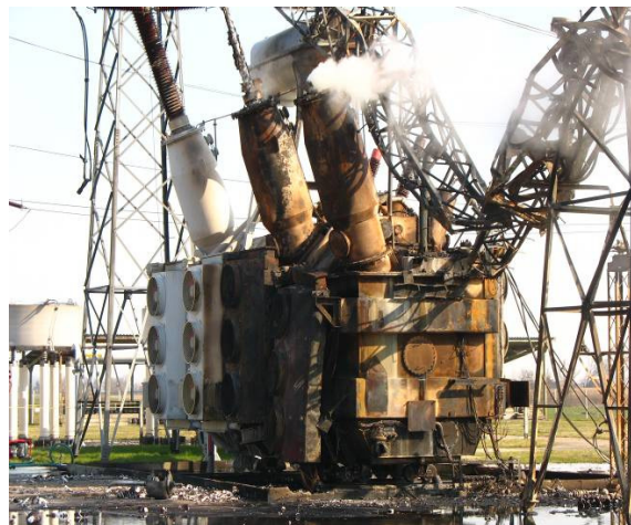
Rys. 3. Uszkodzone w wyniku eksplozji i pożaru przepusty izolatorowe strony 400 kV transformatora 250 MVA
