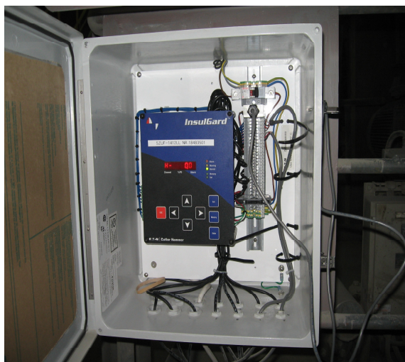
Rys. 2. Widok aparatury pomiarowej. Silnik SZUf-1412LL 1400kW, 6000V, 50Hz, 496obr/min
