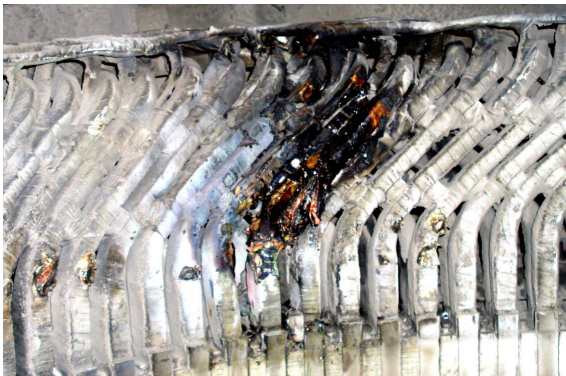
Rys. 8. Skutki uszkodzenia uzwojenia stojana przez zerwane łopatki wentylatora
