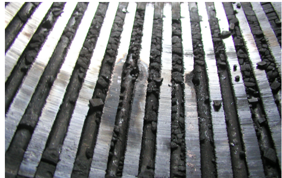
Rys. 17. Zniszczony rdzeń i uzwojenie stojana
