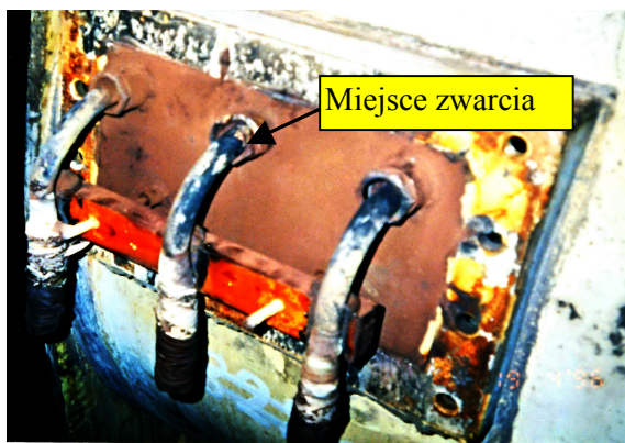
Rys. 18. Widok miejsca zwarcia w nieczynnej skrzynce zasilającej
